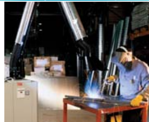
aspiración humos de soldadura
