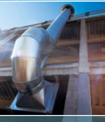
captación de aire exterior
